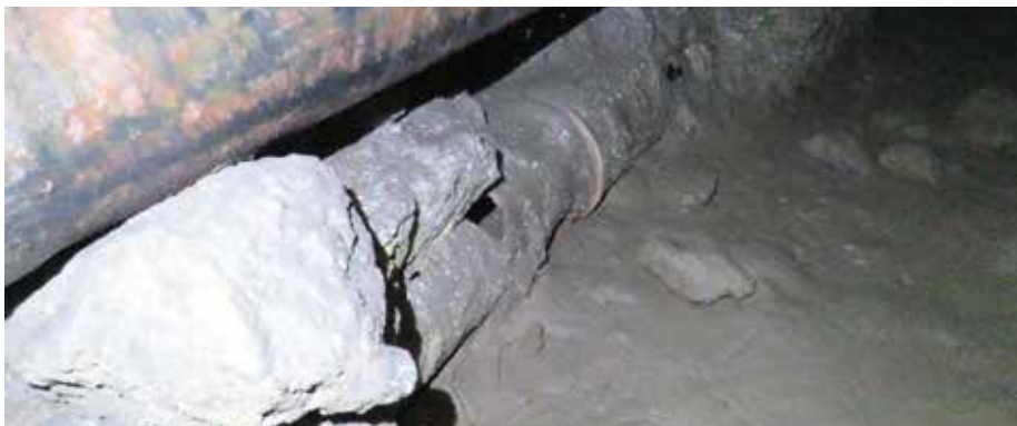
Fig. 16 – Acquedotto ipogeo del Cannellone (Bagnoregio): la tubatura in ghisa ancora oggi in funzione venne posizionata nel 1874 in sostituzione di quella antica di tubi di terracotta, ancora visibile in più punti.
