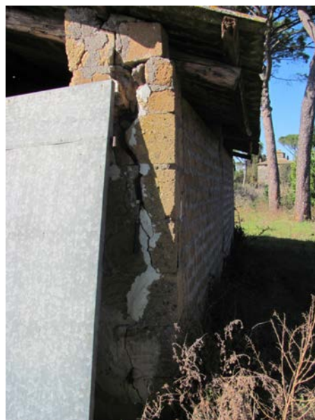
Figura 4 Lesione ad un fabbricato in prossimità del coronamento della paleofrana, imputabile verosimilmente alle fratture estensionali nel tufo.
